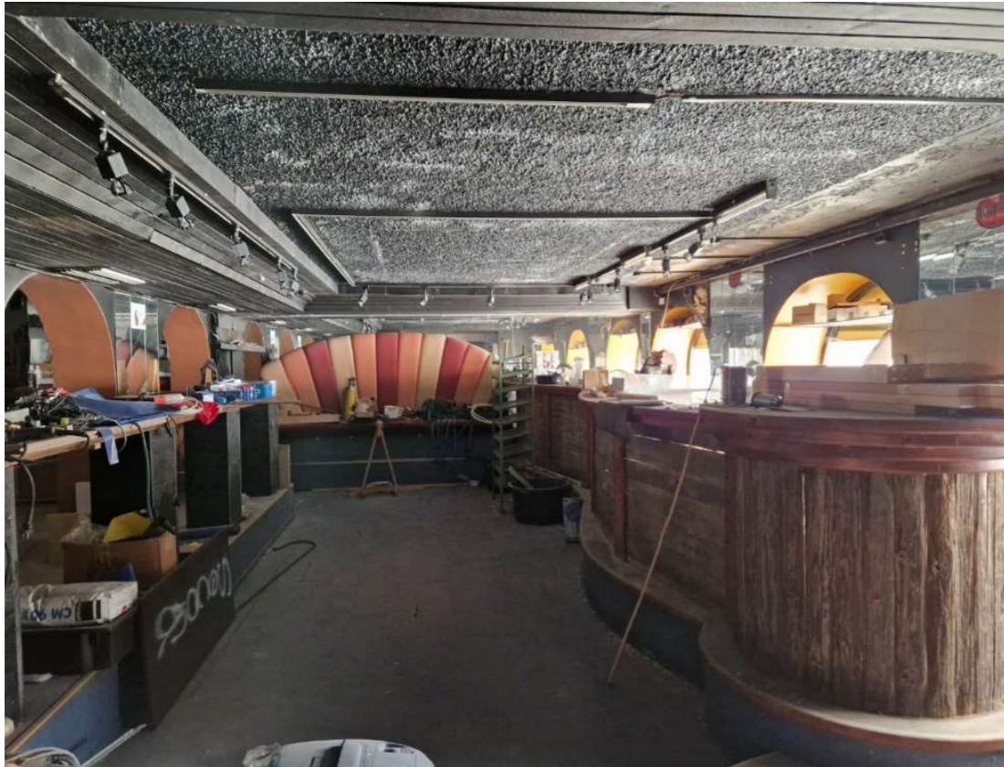
Kuva 37. Kellaritilan yökerho. Lattian alla on entinen uima-allas. Holvi-ikkunat on tehty julkisivuun jälkikäteen. Ensimmäisen altaan kohdalla oli tanssilattia, sittemmin baaritiski.
