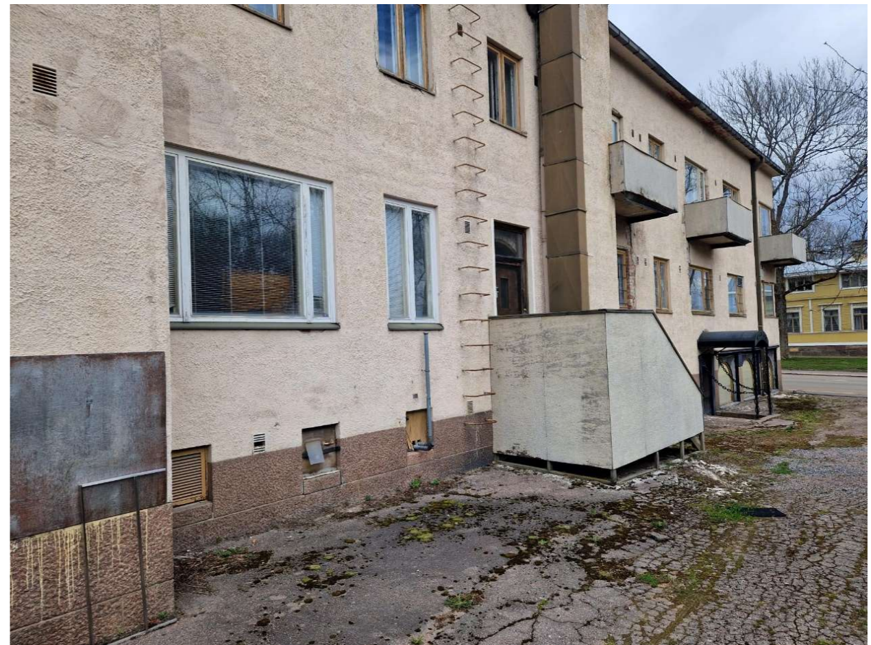
Kuva 28. Rakennuksen eteläjulkisivua. Etualalla uusittuja ikkunoita ja niiden oikealla puolella vuonna 1994 puhkottu uusi yhteys pihalle. Se samoin kuin parvekkeet on levytetty kivilevyin. Ilmeisesti parvekkeiden rapattu pinta on ollut säärasituksen vaurioittama.
