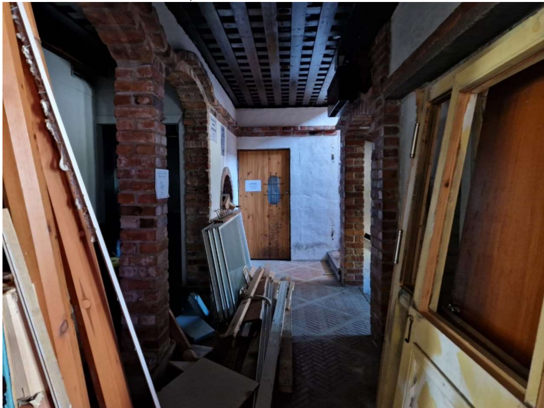
Kuva 38. Hotelli-ravintolan sisäänkäynti oikealla. Vasemmalla on ollut vastaanottotiski, tiiliväliseinä on tehty ravintolaremonttien myötä. Käytävän päässä oleva ovi johtaa länsipään baariin.
