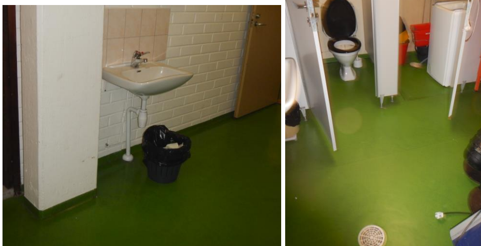
Kuva 2. Pukuhuoneessa 113 (vasemmalla) ja sosiaalitulassa 131 (oikealla) havaittiin paikallisesti kosteutta lattiapinnalla. Kosteus on päässyt muovimaton alle todennäköisesti viemäriliitosten kautta.
